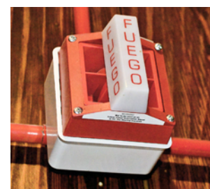
Sirena de la alarma de incendios.
